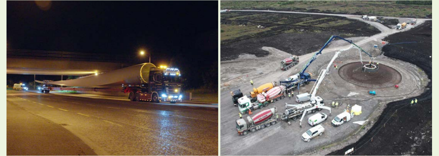
Fíor 4 Na tuirbíní gaoithe á bhfágáil ag an láithreán. Fíor 5 Ag ullmhú chun an coincreít a dhoirteadh do bhunsraith an chéad tuirbín.
